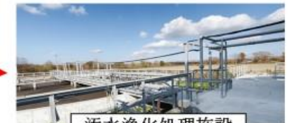
汚水浄化処理施設
