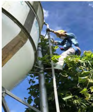
木々が昇降に支障
